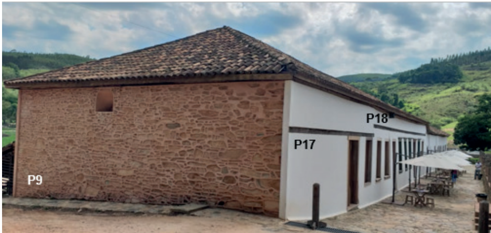
Figura 9. Parede de pedra patrimonial (P9) na Tulha da Fazenda Atalaia construída na técnica canjicado, tendo um cordão de borda saliente em areia e cal e parede. P17 alvenaria em pedra rebocada e P18 Alvenaria em taipa de pilão rebocado. (Fonte: Próprio Autor, 2022).
