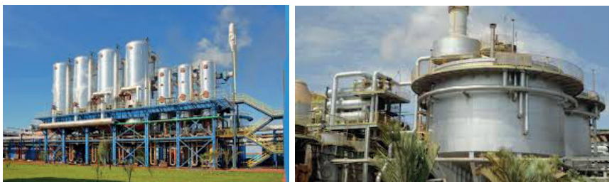
Figura 14: Decantadores utilizados no tratamento do caldo
