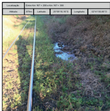
Figura 14 - Presença de água, vegetação e rochas ao lado da pista
