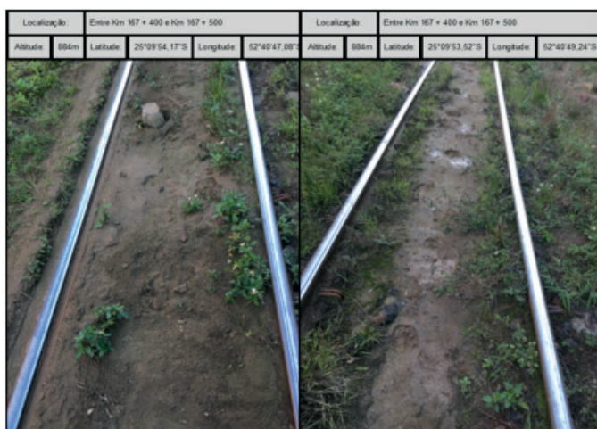
Figura 16 - Acúmulo de solo na linha Férrea
