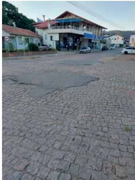
Não conformidades no pavimento
