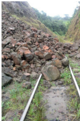
Figura 19 - Deslizamento de detritos.
