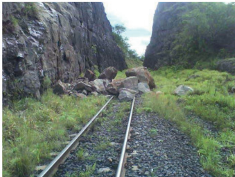
Figura 18a - Queda de barreira
