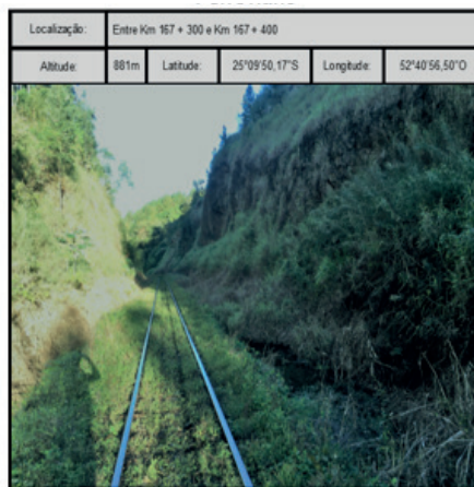
Figura 13 - Presença de Água no Talude Ferroviário
