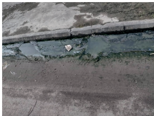
Figura 12 – Ruas com esgoto a céu aberto
