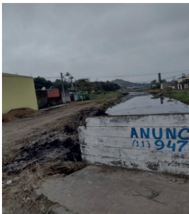
Figura 11– Ruas sem drenagens de águas pluviais
