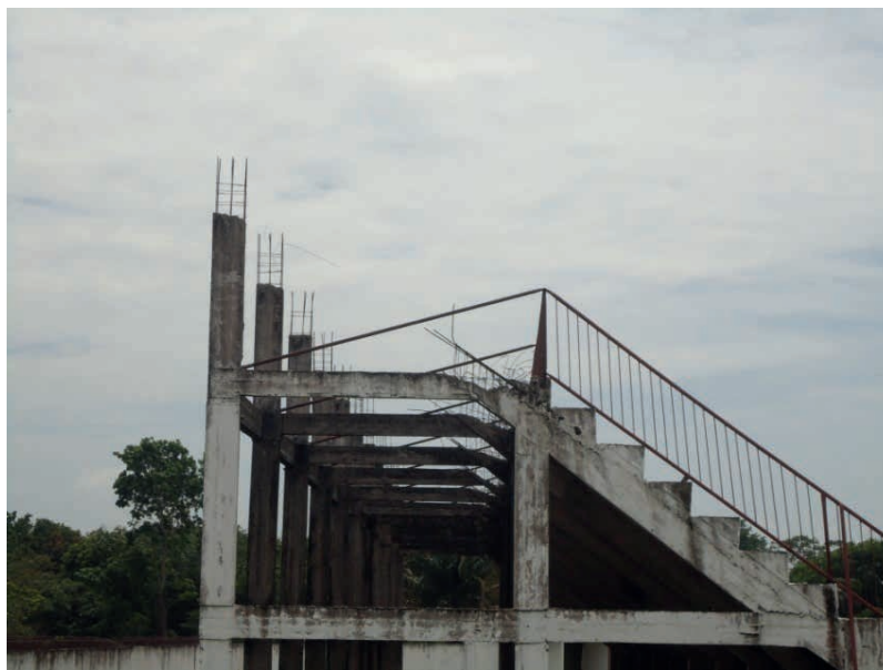
FIGURA 28: Parte da arquibancada inacabada do estádio municipal.
