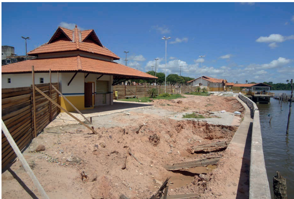
FIGURA 26: Imagem do cais quase caindo.
