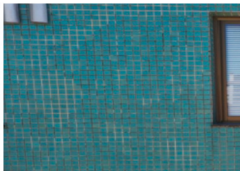
Figura 15 - Juntas deterioradas em região do 17º pavimento de O4
