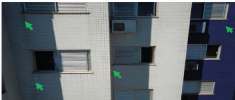
Figura 28 - Sujidades na direção norte da Edificação B.
