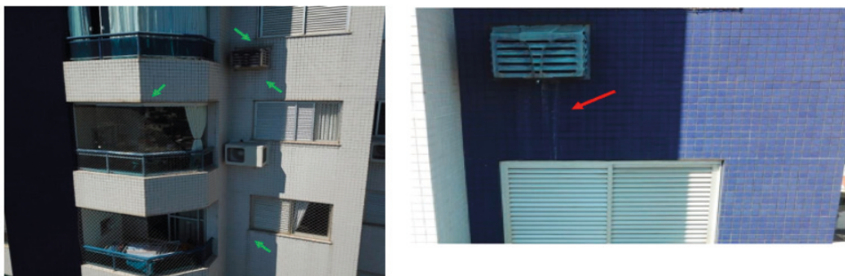
Figura 23 - Sujidade nas fachadas N3 e N4 e Eflorescência em N1.
