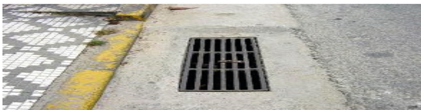
Figura 4 - Boca de lobo com grelha
