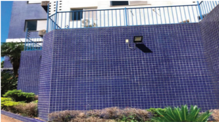
Figura 07 - Face externa dos muros da edificação B.
