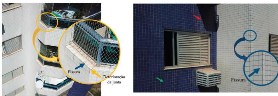
Figura 24 - Deterioração da junta, e fissura nas placas cerâmicas presente na fachada L1 e Eflorescência e sujidade na N9 e fissura na L3.
