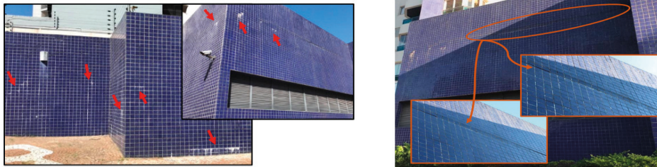
Figura 20 - Eflorescências nos muros e Estufamento do revestimento cerâmico no muro da edificação B.
