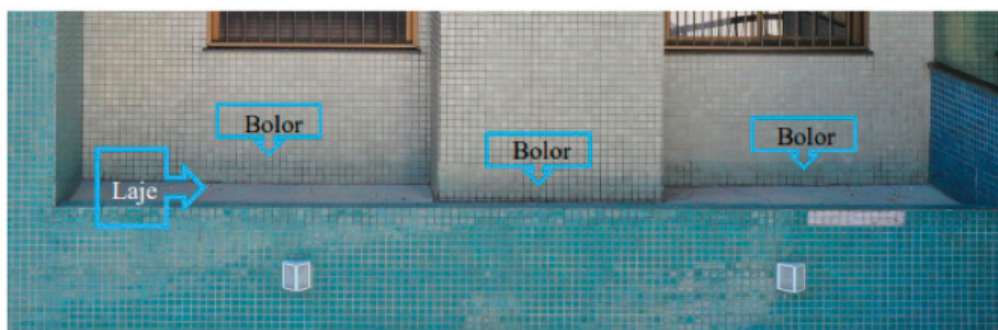
Figura 27 - Ocorrência de bolor na região da direção norte – Edificação A.
