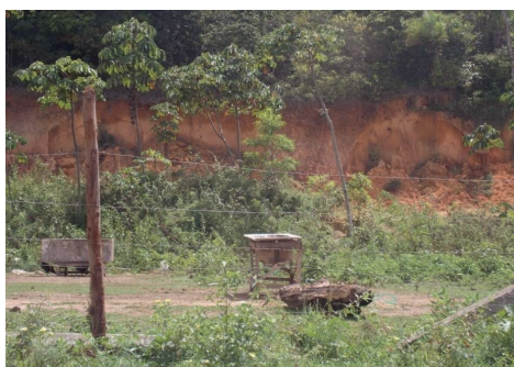
Figura 25: Erosão não identificada
