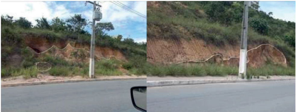
Figura 18: Erosão do tipo subterrâneo
