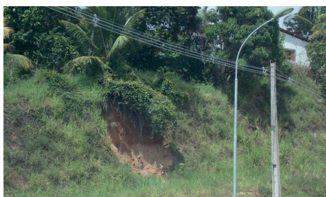
Figura 22: Possível desprendimento da massa de solo
