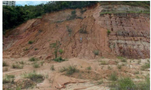
Figura 20: Sulcos provocados pela erosão
