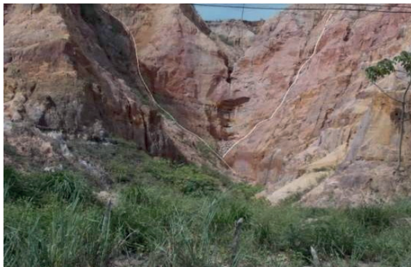
Figura 8: Patologia referente ao trecho 1
