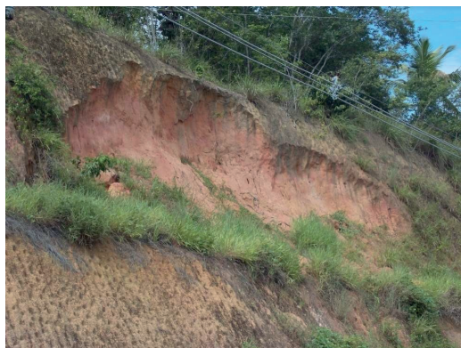
Figura 13: Desprendimento ou queda
