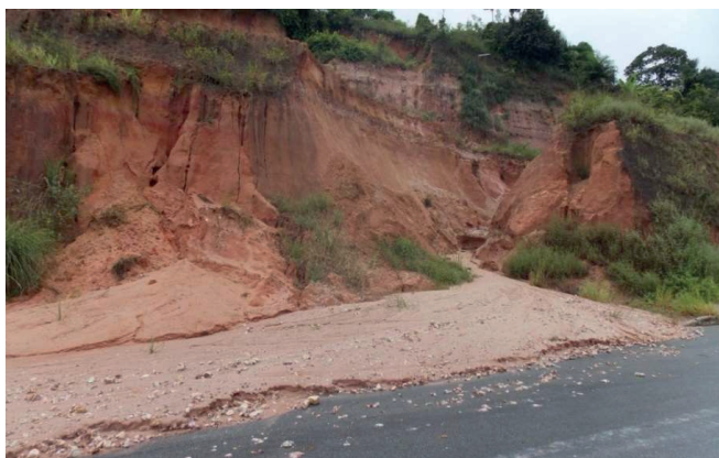
Figura 7: Pista parcialmente invadida por deslizamento de terra
