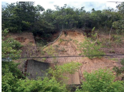
Figura 11 : Desprendimento de terra
