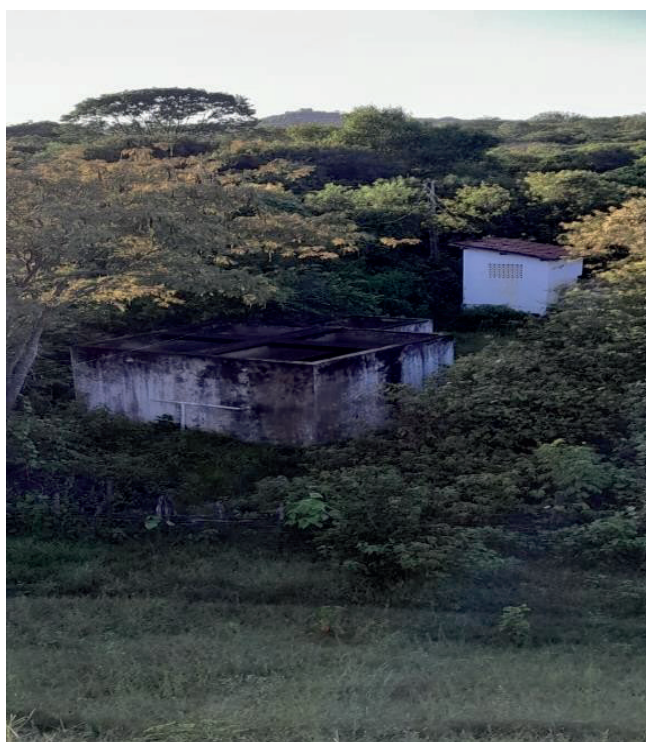
Figura 03: Estação de Tratamento de Água – ETA (Lagoa Escondida).
