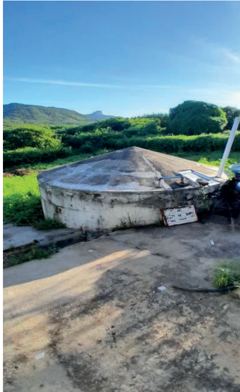
Figura 06: Cisterna para captação de água de chuva (Lagoa Escondida)
