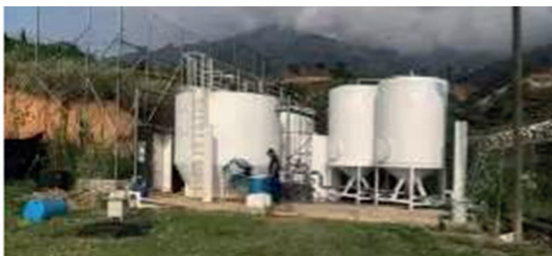
Figura 8. Planta de Tratamiento de Agua Potable N°1 (PTAP 1)
