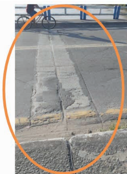
Figura 14 – Ponte Flávio de Miranda Gonçalves, junta de dilatação.
