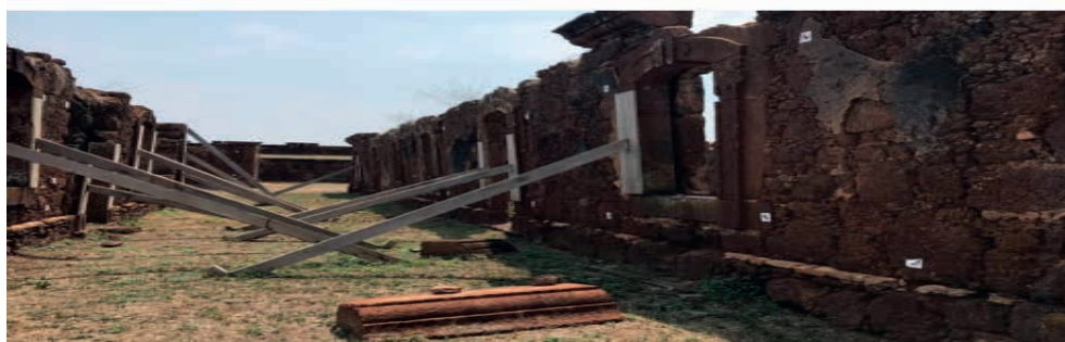
Figura 7: Vista de conjunto de edificações na praça de armas com escoramentos aplicados. Fonte: Arqueolog, Pesquisa, 2020.
