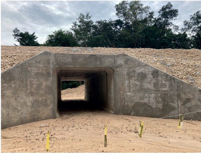
Imagen N° 3. Paso de fauna.
