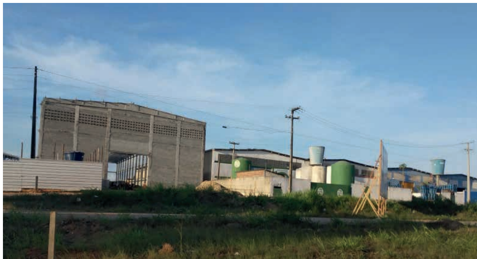
Figura 1 – Construção de galpão pré-moldado ao lado de outros estabelecimentos já em funcionamento em estrutura predial de mesma forma, Distrito Industrial de Vitória de Santo Antão (BR-232)
