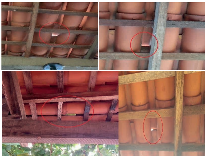
FIGURA 3. Baldosas mal colocadas
