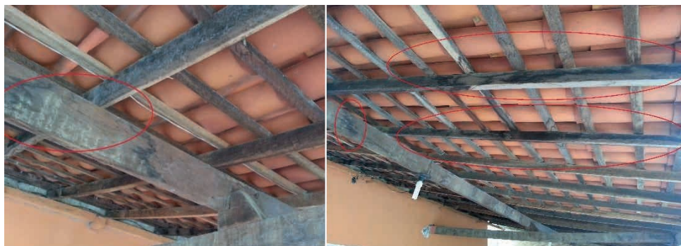
FIGURA 4. Manchas de humedad
