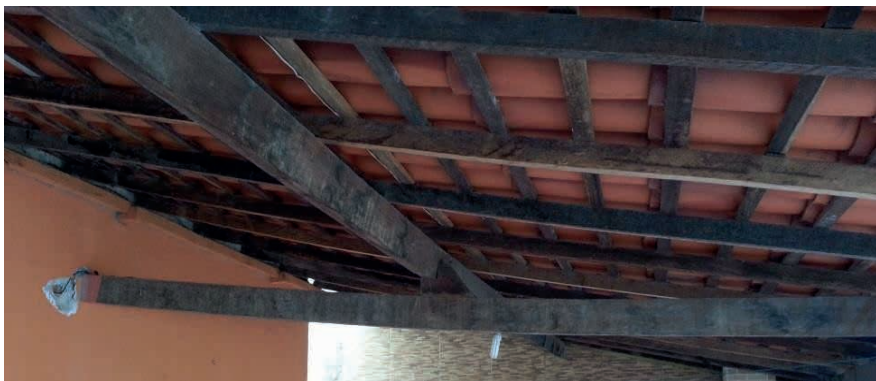
FIGURA 2. Viga doblada con fluencia de apoyo
