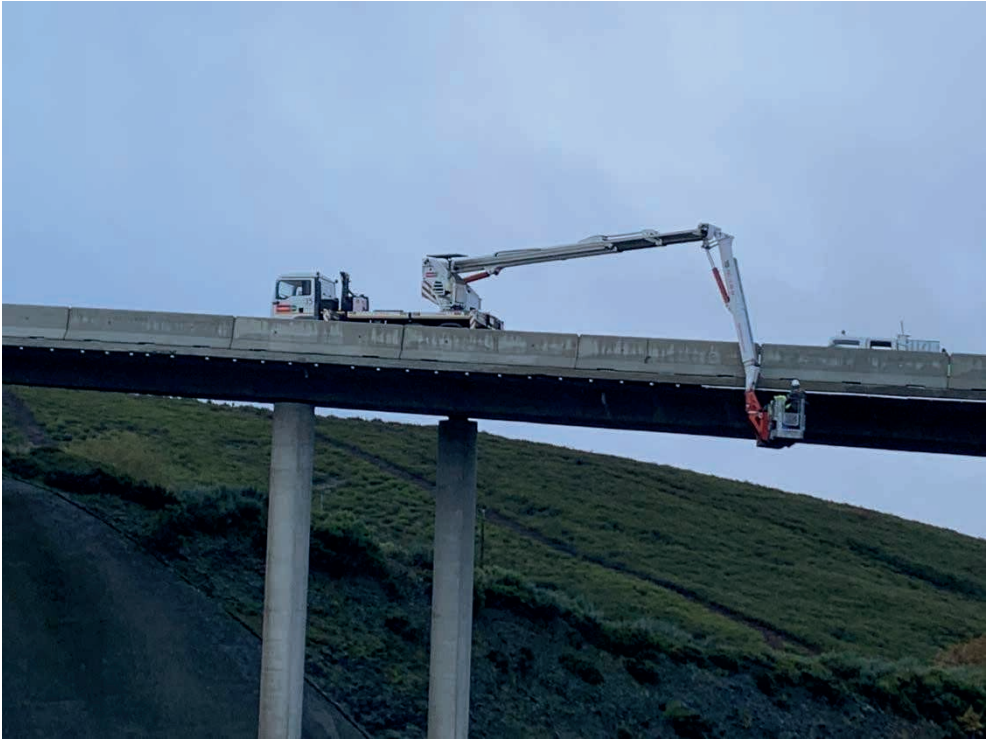
Figura 1: Inspección del tablero de un viaducto que salva la Autovía de las Rías Bajas (A – 52), a la altura del municipio de A Gudiña, en la provincia de Ourense (fotografía del autor).
