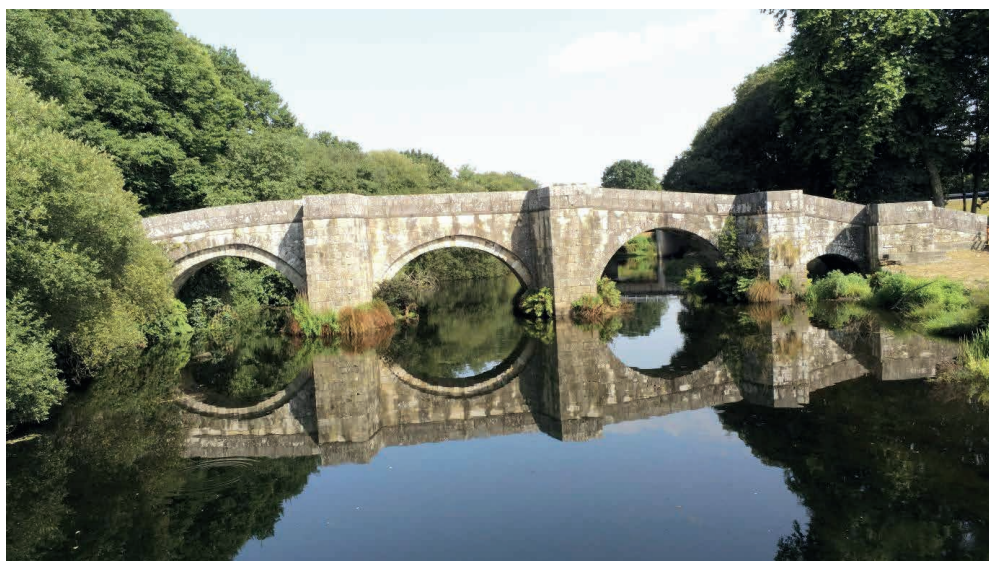
Figura 3: Vista general del alzado aguas abajo del Puente de Brandomil, en imagen captada con el drone multi rotor empleado en la inspección de este artículo (fotografía del autor).
