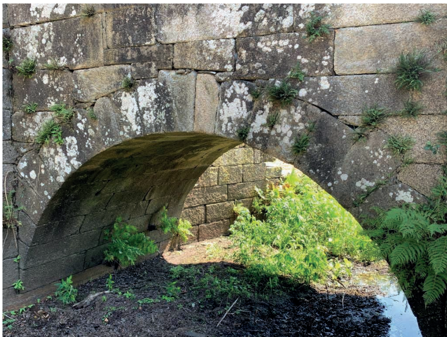
Figura 9: Vista general del arco más pequeño del Puente de Brandomil, visto desde el lado aguas arriba, en imagen captada con el dron multi rotor empleado en la inspección, donde se puede observar la abundante presencia de vegetación enraizada en los múltiples elementos (fotografía del autor).
