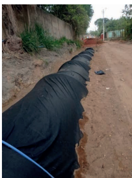
Figura 11 – Tubulação envolta em manta geotêxtil e areia nas laterais para contenção da tubulação. Detalhe para a ausência das bordas externas da manta geotêxtil, a manta foi cortada e roubada na noite anterior à realização da foto.
