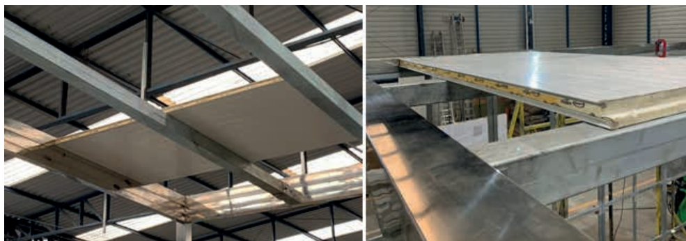
Figura 16 - Painel térmico sobre barrotes metálicos
