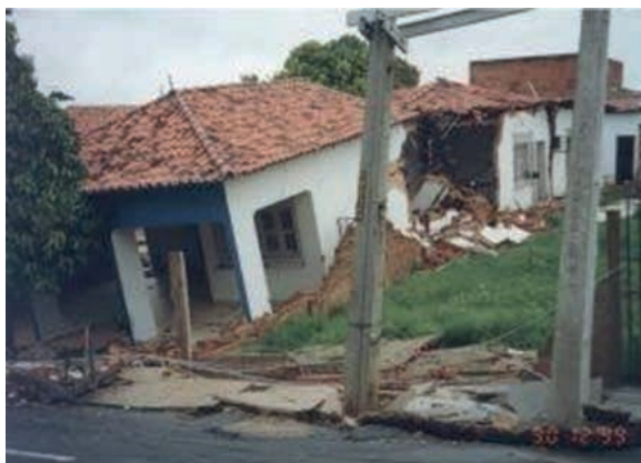
Figura 15: Consequência das patologias na fundação
