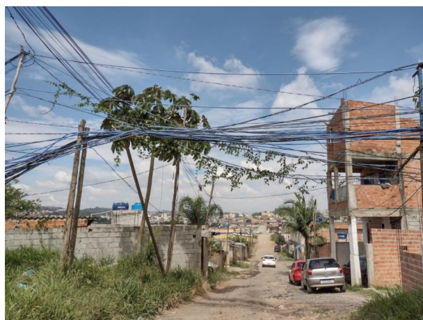
Figura 3: Mangueiras das ligações clandestinas.
