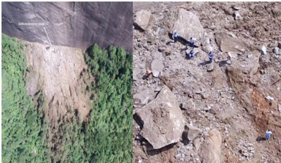
Figura 3 - Área remanescente no local do impacto da lasca com o bloco já existente na base do talude rochoso e detalhamento da fragmentação do bloco (Relatório Inspeção SUBPERD, 2018)
