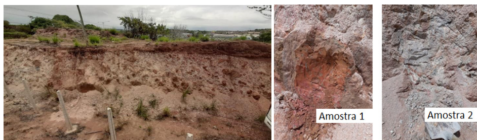
Figura 1: Talude de onde foram retiradas as amostras dos solos para ensaios e as amostras 1 e 2. Fonte: Autores.
