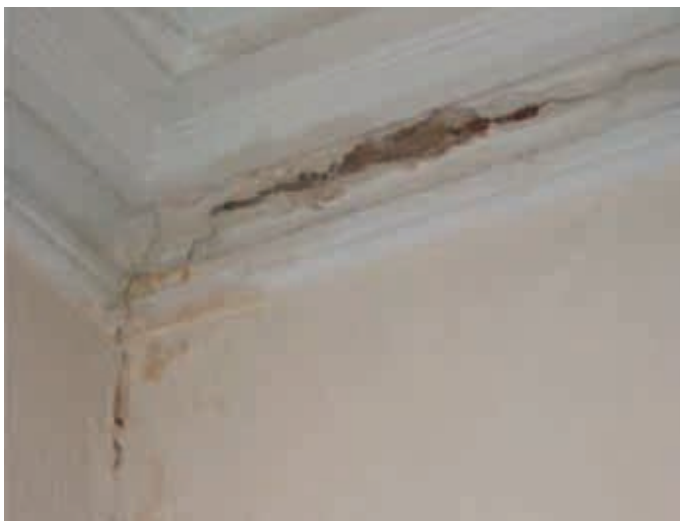
Figura 9 – Gesso danificado pela umidade
