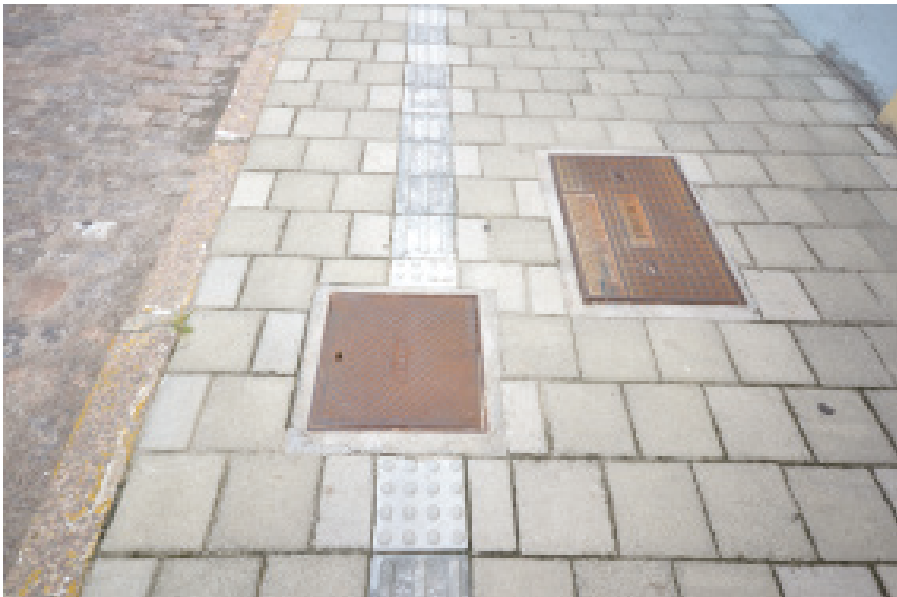
Fig. 20 Piso podotátil não utilizado de maneira correta.
