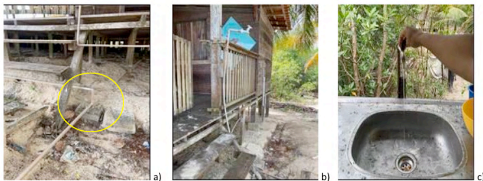
Figura 3 – a) tubulações simples de canos de PVC 25mm, b) torneiras direto dos canos e c) torneiras instaladas dentro das residências, na comunidade pesqueira da praia Olho de Porco, Paço do Lumiar, MA, Brasil.
