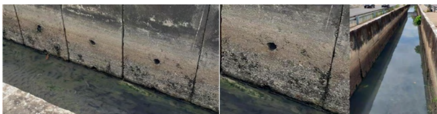
Figura 6 Desgaste por abrasão nas paredes laterais do canal
