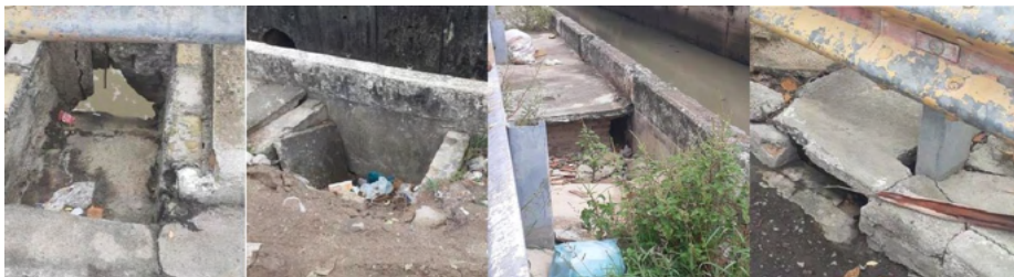
Figura 4 – Bocas coletoras depreciadas
