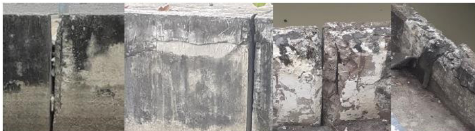
Figura 9 – Deslocamento do concreto.
