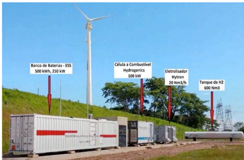
Figura 1 – Sistema de Armazenamento de Energia Elétrica na forma de hidrogênio instalado na UHE de Porto Primavera (6)
