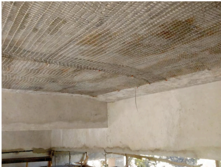
Figura 16 – Aplicação do Reforço da Face Inferior da Laje com Malha de Fibra de Carbono.
