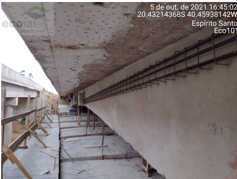
Figura 10 – Foto dos Cabos com Armadura da Proteção contra Vandalismo.
