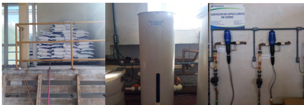
Figura 7: Sistema de purificação do hipoclorito de sódio.
