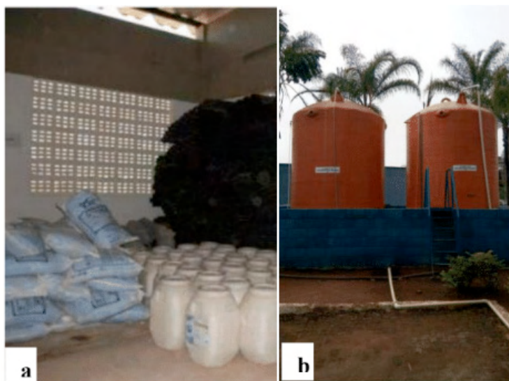
Figura 3: (a) local de armazenamento de sulfato de alumínio em pó em ETA (b) tanque de armazenamento do cloreto de polialumínio (PACl) utilizado pelo DMAE-Uberlândia.
