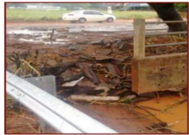
Figura 6 - Ponte sobre o Córrego Danificada após a Chuva (Rotatória Rua Rachid Neder)
