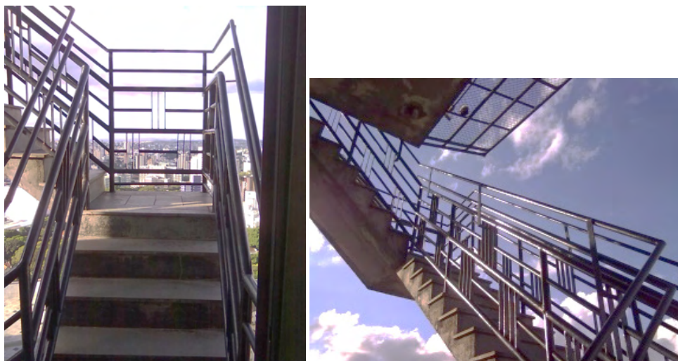
Figuras 14 e 15 – Guarda-corpo e corrimão da escada que liga o último andar tipo da edificação à PDC com altura aumentada.
