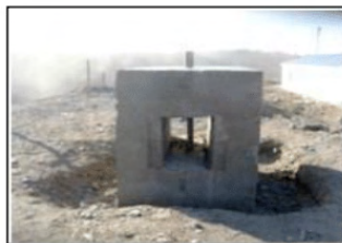
Foto de un Punto de Anclaje.
