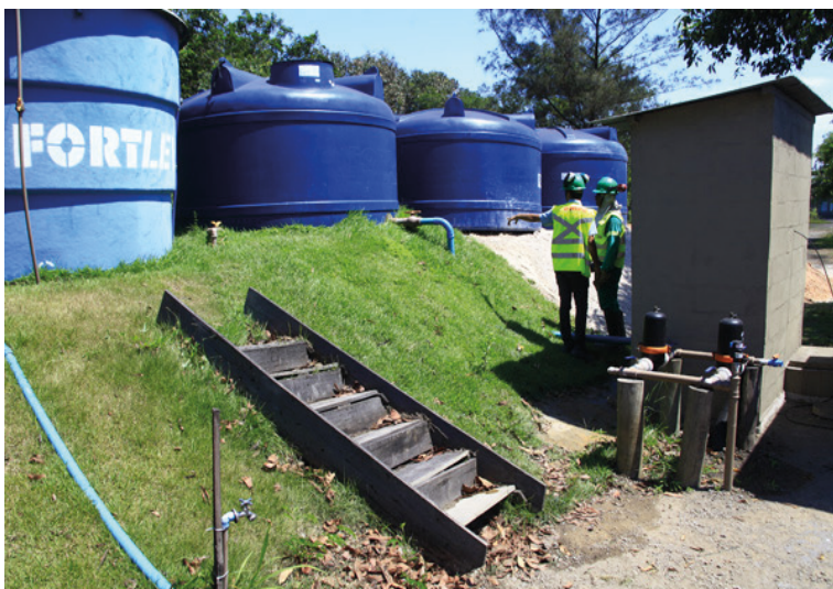
Figura 7 – Sistema de fertirrigação.
