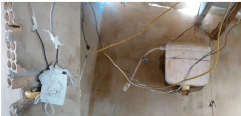
Figura 5 – Fiação exposta, alto número de emendas
