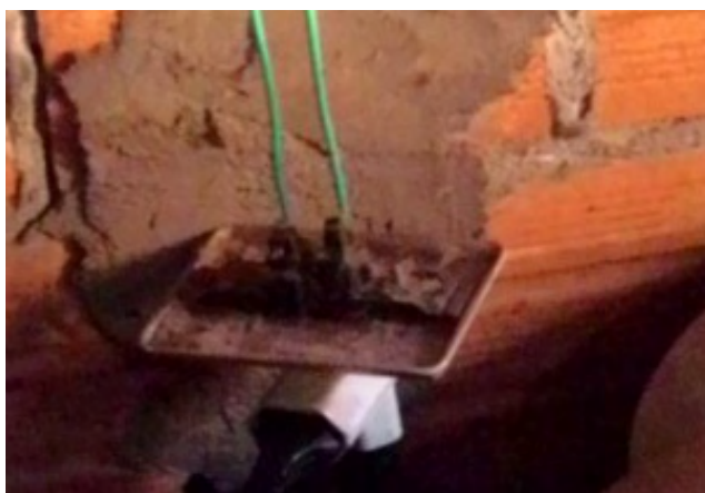
Figura 4 – Interruptor de luz não afixado
