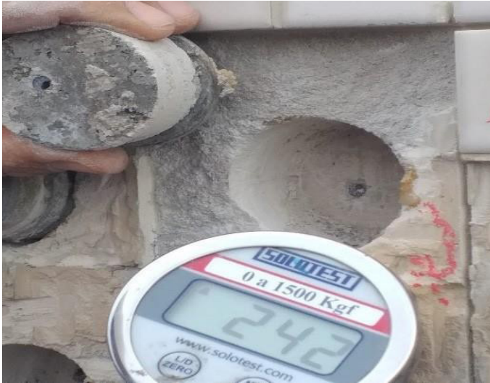
Figura 7. Ensaio de arrancamento protótipo B – Ruptura na interface substrato/chapisco.
