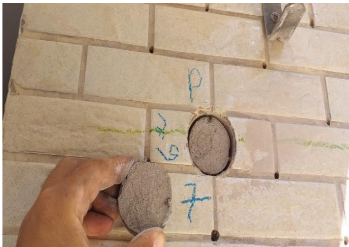
Figura 9. Ensaio de arrancamento protótipo D – Ruptura no interior da argamassa de emboço.
