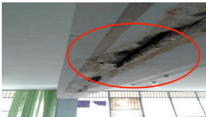
Figura 6. Disgregação do concreto
