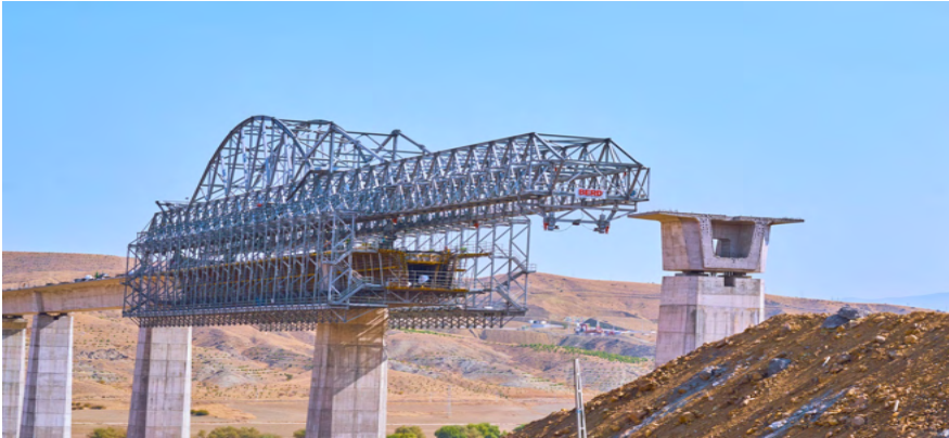
Figura 12. Imagen del M1-90-S en fase operación.
