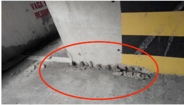
Figura 1. Corrosão da armadura na base do pilar.
