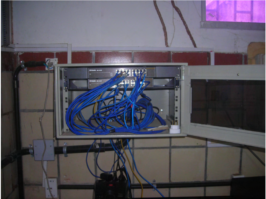
Figura 15 – Detalhe do bastidor de roteadores wireless na EMEF Juscelino Kubitschek
