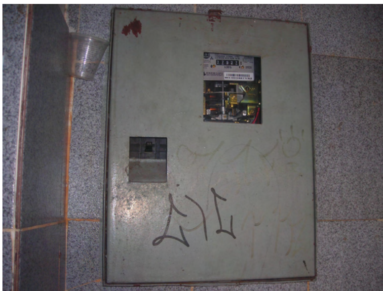
Figura 12 – Quadro de entrada de energia do prédio 1 da EMEF Santa Rita de Cássia
