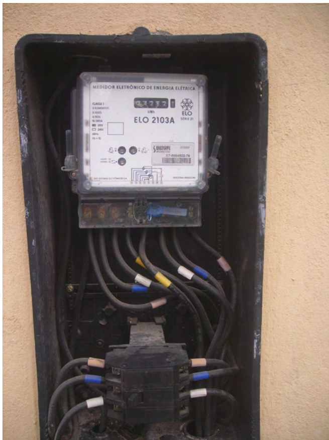
Figura 13 – Quadro de entrada de energia do prédio 2 da EMEF Santa Rita de Cássia
