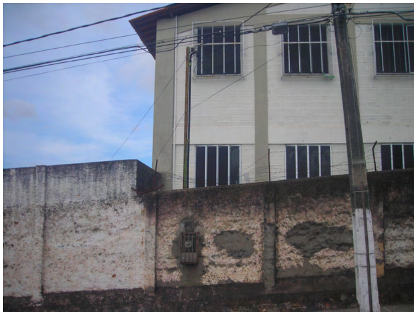
Figura 11 – Infraestrutura da entrada de energia da EMEF Santa Rita de Cássia
