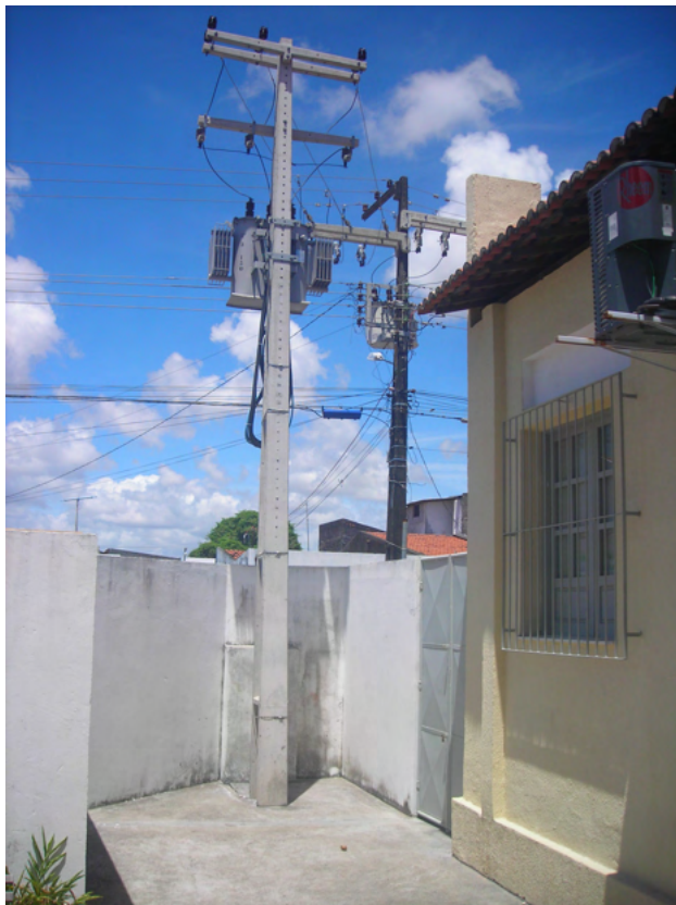
Figura 10 – Infraestrutura da entrada de energia da EMEF Presidente Vargas
