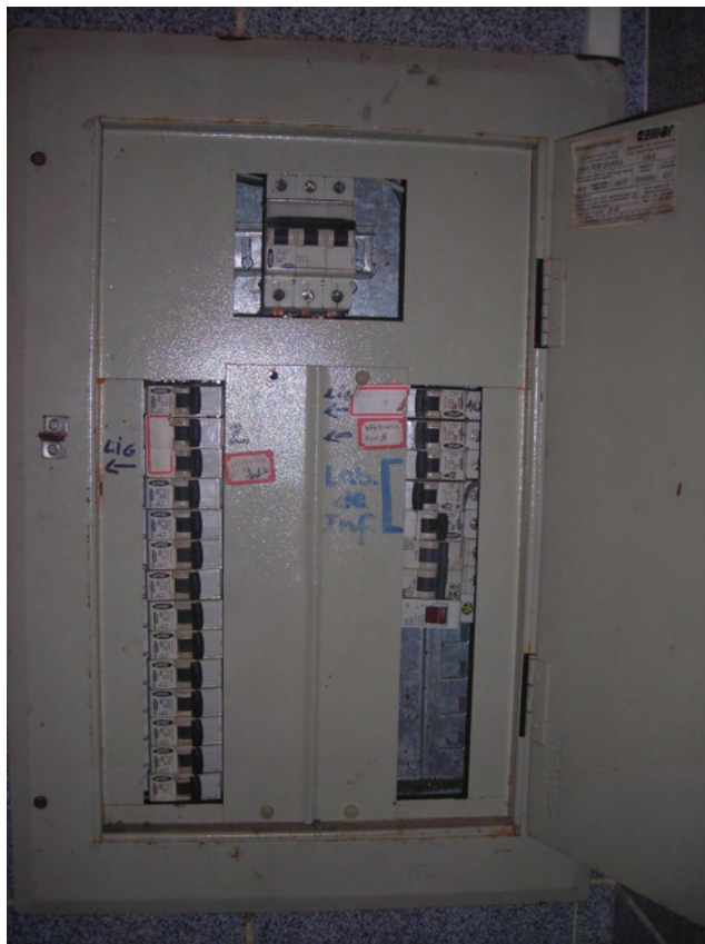
Figura 14 – Quadro de distribuição interna de energia do prédio 2 da EMEF Santa Rita de Cássia
