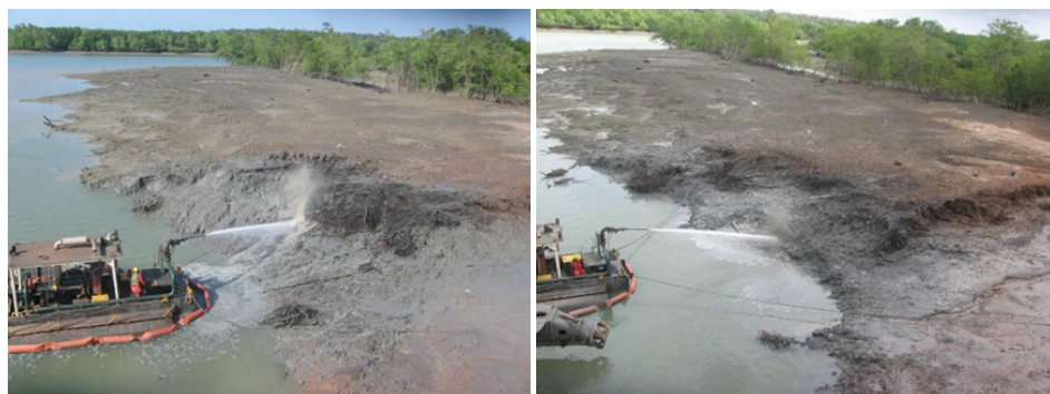
Figuras 4 e 5. Dragagem superficial da área para retirada de troncos e tocos e posterior recobrimento com geotêxtil e sistema de confinamento celular.
