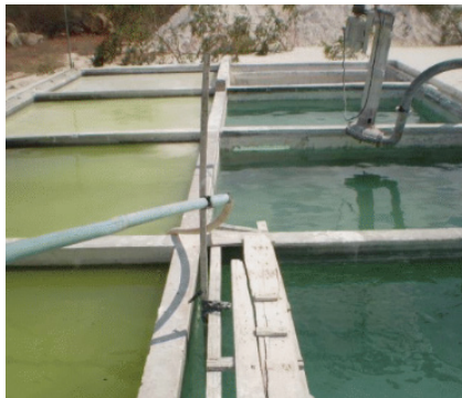
Figura 09: Efluente do beneficiamento com tratamento em circuito fechado.
