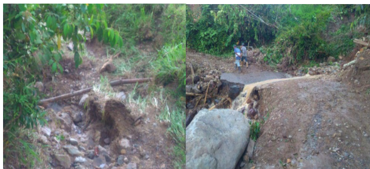
Figura 3. Tubería de conducción impactada por la crecida de la quebrada La Paja, fuertes lluvias acaecidas en el páramo El Portachuelo- sector San Francisco.
