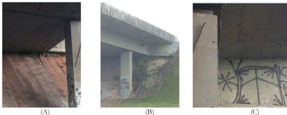
Figura 9. Elevado Mário Covas. (A) Infiltração; (B) Manchas escuras; (C) Fissuras e deterioração.
