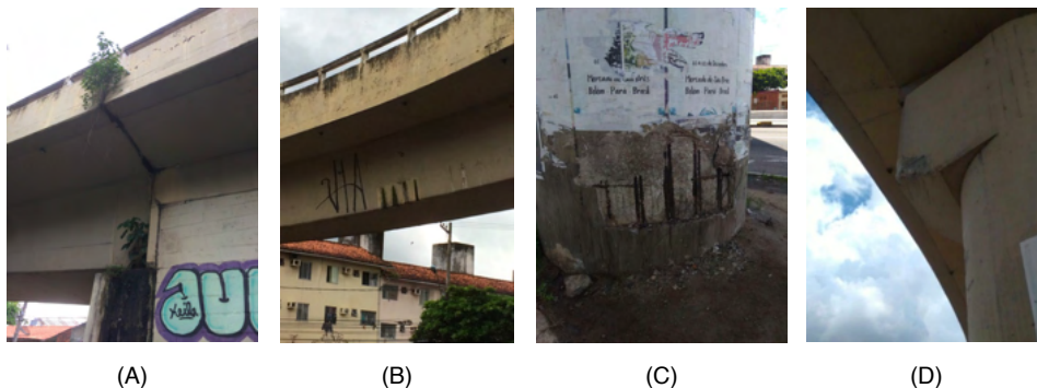
Figura 6. Elevado Mariguela. (A) Fungos; (B) Manchas; (C) Exposição e corrosão de armaduras e (B) Ações Mecânicas.
