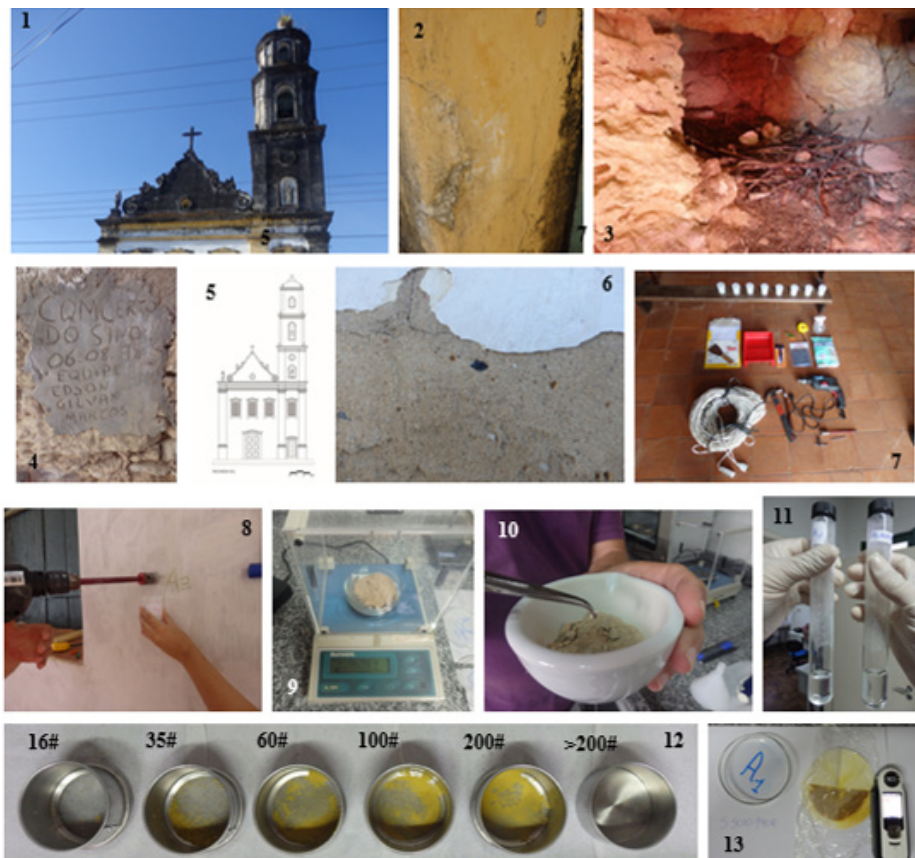
Figura 3: (1) - Frontão atacado por umidade e manchas negras e torre tendo a cúpula sendo atacada também por vegetação aérea; (2) - Ataque por sais na ombreira lateral esquerda da portada principal; (3) - Ninho de pássaro na parede interna da cúpula; (4) - Registro de conserto do sino; (5) - Desenhos da Igreja produzidos pelo grupo de pesquisa Projeto IC PVF-5238 – Fachada Sul; (6) – Pareda da fachada norte, Argamassa rica em carvão e cal, pouca argila vermelha e muito arenoso (processo de descolamento); (7) - Equipamentos para recolha das amostras; (8) - Perfuração amostra A3; (9) - Placas de petri; pesagem amostra A2 úmida; (10) - Amostra destorroada e retirada de resíduos como fibras vegetais; (11) - Análise Sulfatos; (12) - Resíduos retidos da amostra C1 nas peneiras 16; 35; 60; 100; 200 e >200; (13) - Aferição cor dos finos da amostra A1; uso colorímetro digital NCS (Natural Color System) modelo RM 200. Acervo: SILVA, EDER D. jun. 2018.
