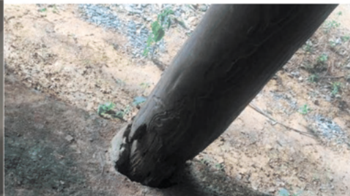
Figura 5 – Desgaste no pilar de sustentação
