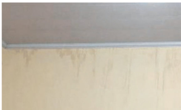
Figura 6 – Infiltração parede interna da cozinha
