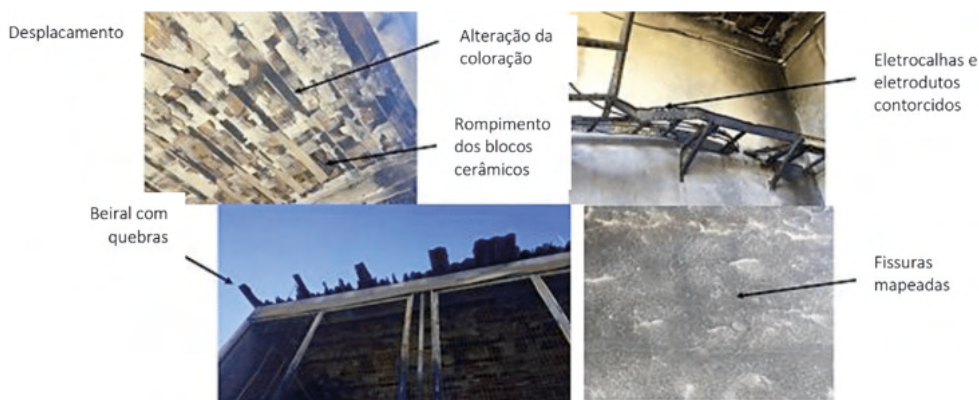
Figura 2 - Condições da edificação
