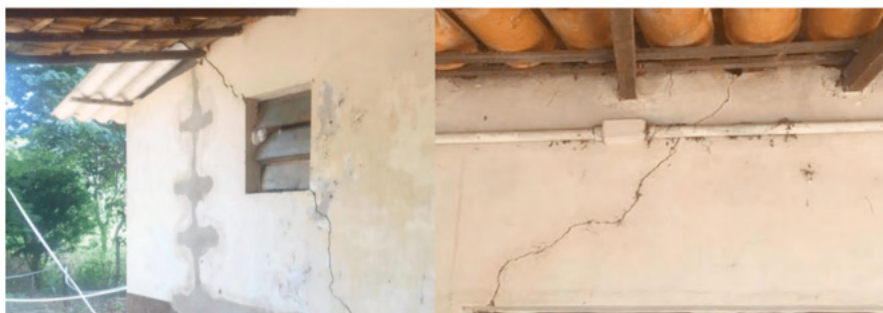
Figura 2 – Trincas e fissuras área externa Figura 3 – Trinca e descascamento da pintura
