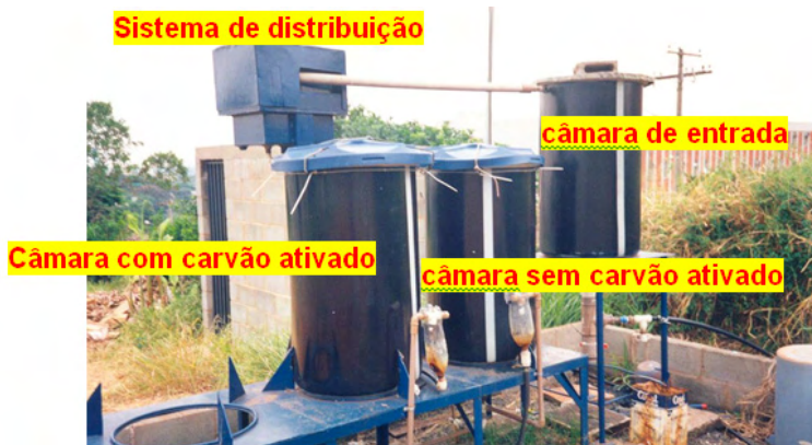
Figura 5: Detalhe do conjunto de filtro lento.
