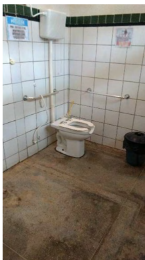
Fig. 18: Vaso e barras inadequadas Fonte: Projeto Extensão, 2018
