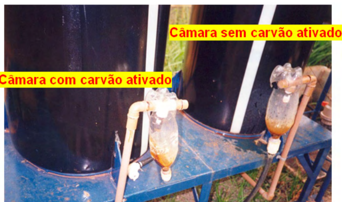
Figura 6: Detalhe do conjunto de filtros lentos.
