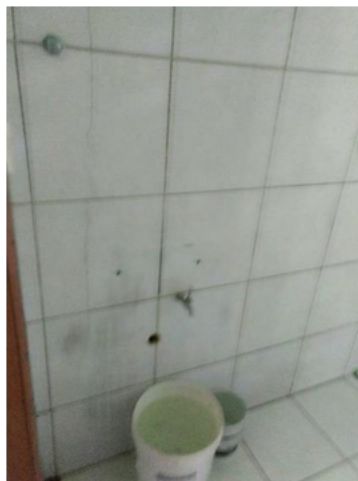
Fig. 24: Não existe pia no banheiro.
