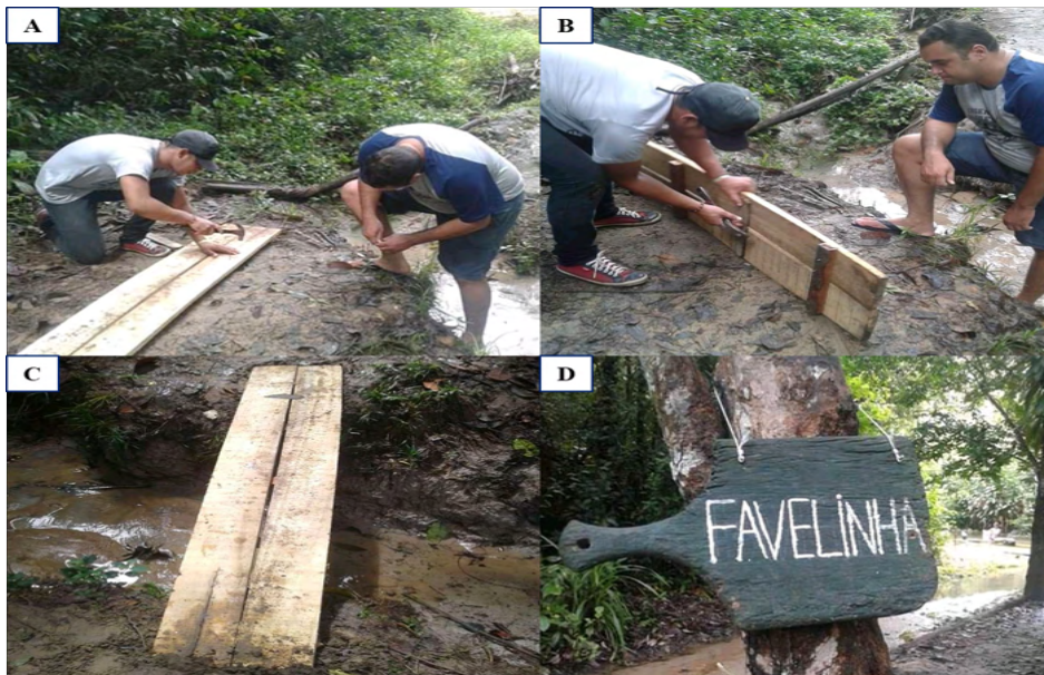
Figura 10 – Confecção de uma nova ponte de acesso ao igarapé (A) e (B); ponte de acesso já alocada no seu local (C) e placa com identificação do nome do Igarapé elaborada pelos membros do projeto.
