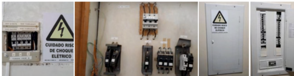
Figura 11 - Quadros elétricos encontrados nas dependências do Hospital Escola.
