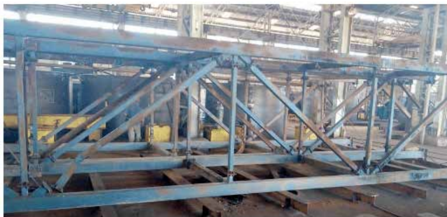
Figura 3 – Vista de parte da estrutura, com diversas regiões em avançado estado de corrosão.
