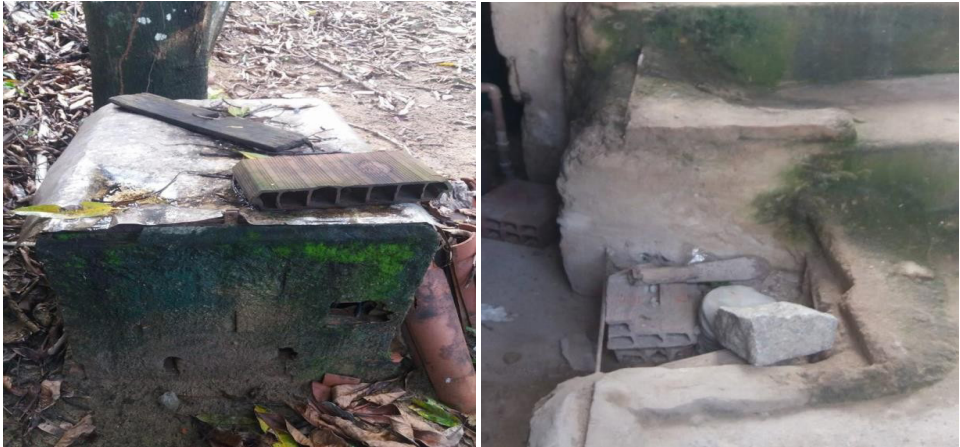
Figuras 5 e 6. Estruturas Inadequadas das Caixas de Bomba para os poços. Fonte: Os Autores (2020).
