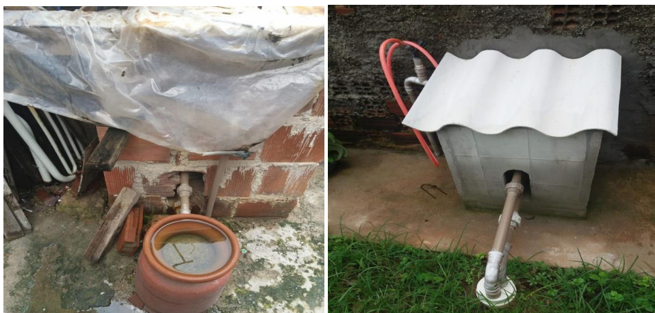
Figuras 3 e 4. Estruturas das Caixas de Bomba para os poços. Fonte: Os Autores (2020).
