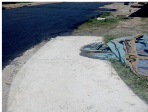
Fig 2: Calçadas obstruídas ou inacabadas
