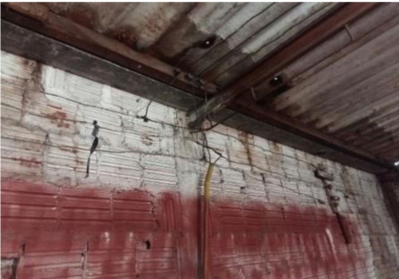
Figura 2 - Instalação Elétrica e Estrutura Comprometida
