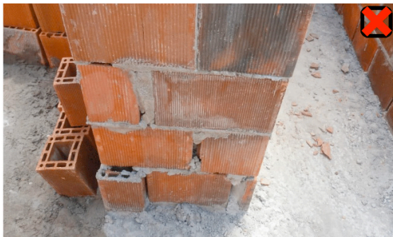
Figura 03: Sem janelas de inspeção
