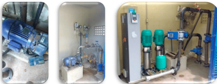
Imagem 02, 03 e 04 - Sistema de Bombeamento antes e Depois de implantado
