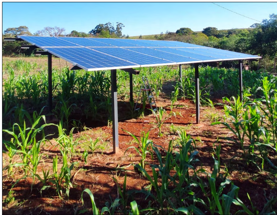
Figura 3 – painel fotovoltaico da comunidade
