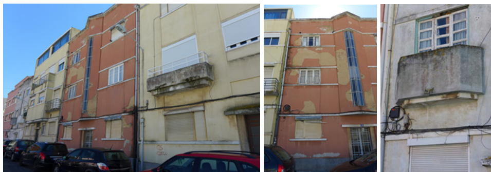
Figuras 12, 13, 14 - Fachadas degradadas de edifícios recentes. (Reaes Pinto)
