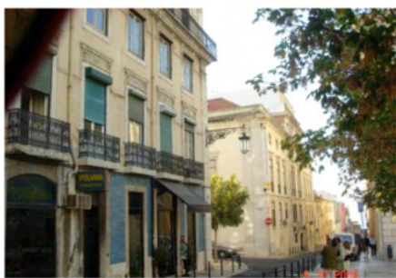
Fig 1 - Fachada degradada num edifício tradicional pombalino (Reaes Pinto)
