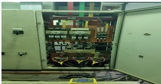
Figura 7 - Conexão do medidor no barramento secundário de T1
