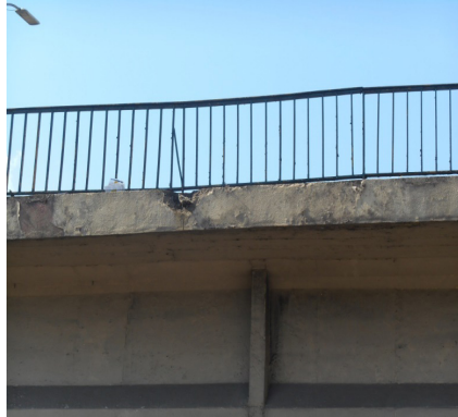
Figura 11 - Concreto disgregado na laje de passeio (Autor)
