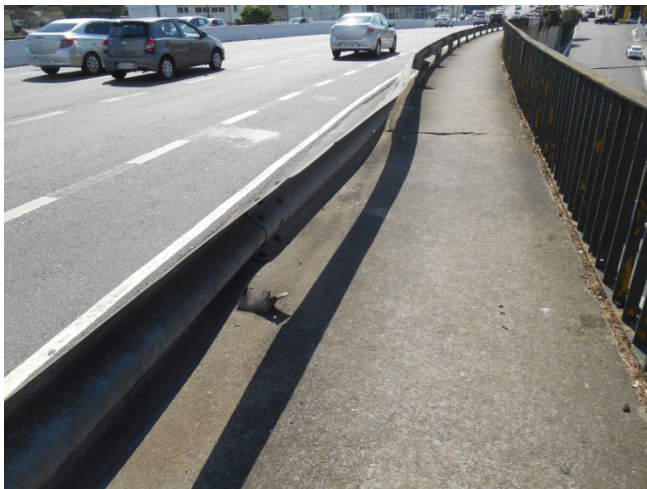
Figura 22 – Defesa metálica com desalinhamento (Autor)
