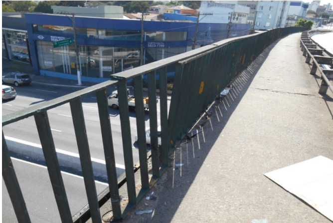
Figura 21 - Guarda-corpo danificado (Autor)
