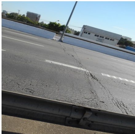
Figura 20 - defeito na junta de dilatação (Autor)
