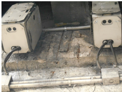
Figura 13 - Armadura exposta e oxidada (Autor)
