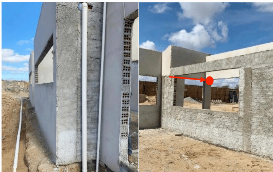
Figura 6 e 7- Incompatibilidade entre arquitetônico e água pluvial e Incompatibilidade entre esquadria e elétrico
